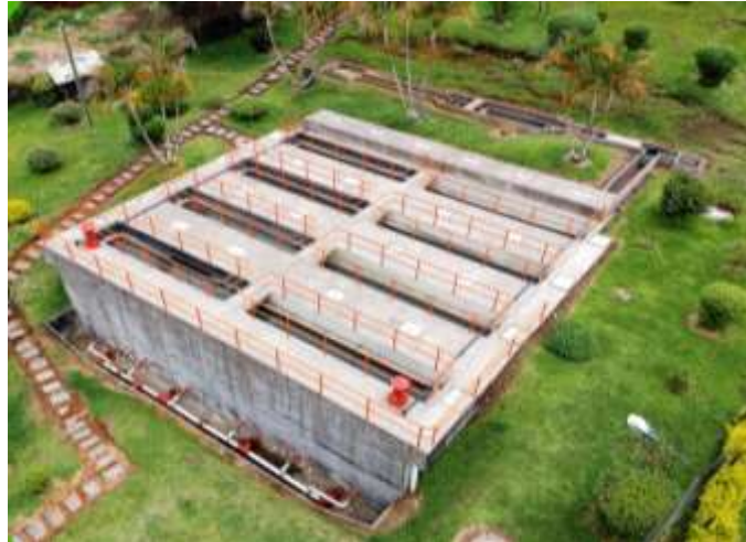
Fotografía 5-50. Planta de tratamiento de aguas residuales Sector Rio Piedras, en el municipio de Jericó, Antioquia
