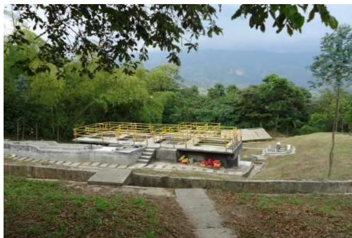
Fotografía 5-49. Planta de tratamiento de aguas residuales sector Guarcitos en el municipio de Fredonia, Antioquia
