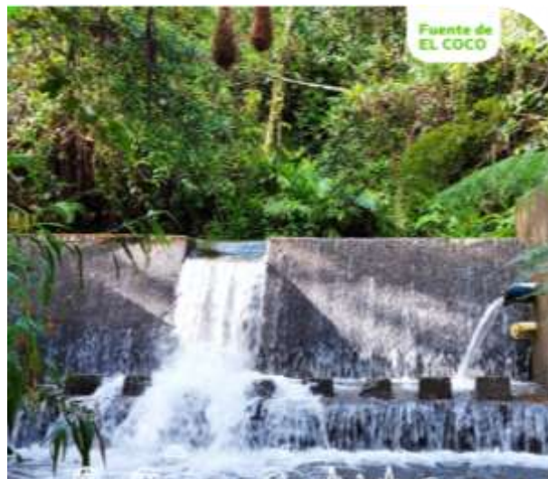
Fotografía 5-48. Captación quebrada El Coco, acueducto municipio de Jericó
